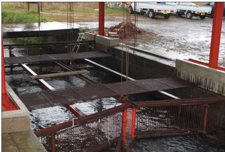
Рис. 10. Завод Минова построен рядом с руслом реки Ушиватаригава. Металлическая ловушка, полностью перекрывающая реку, поднимается лебедками
